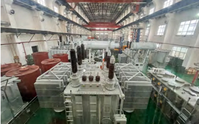
Transformer Assembly Workshop Цех сборки трансформаторов
